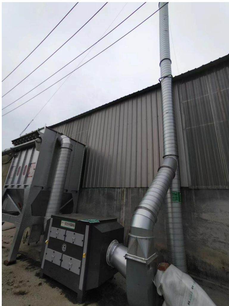
布袋除尘器+生物除臭装置
