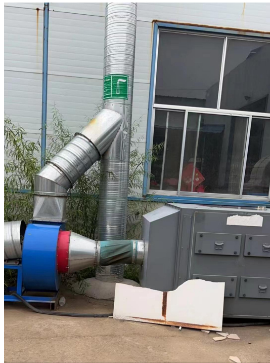
活性炭吸附处理设施
